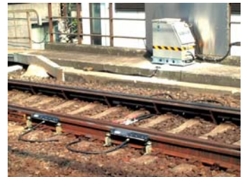
写真3 塗布装置(地上塗布タイプ)
