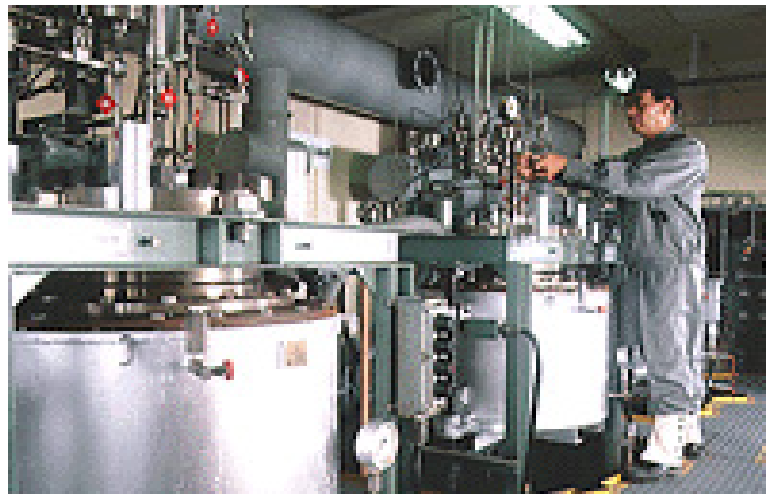
写真1 オートクレーブ腐食装置の外観
